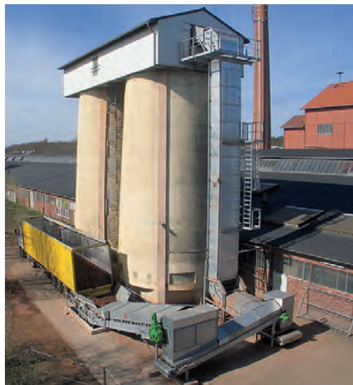
* Remplissage silo par double bande
