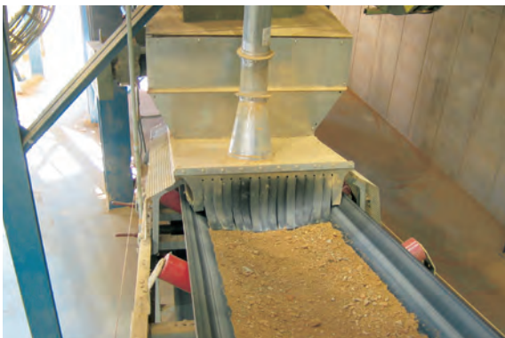
* Zone de chargement avec aspiration
