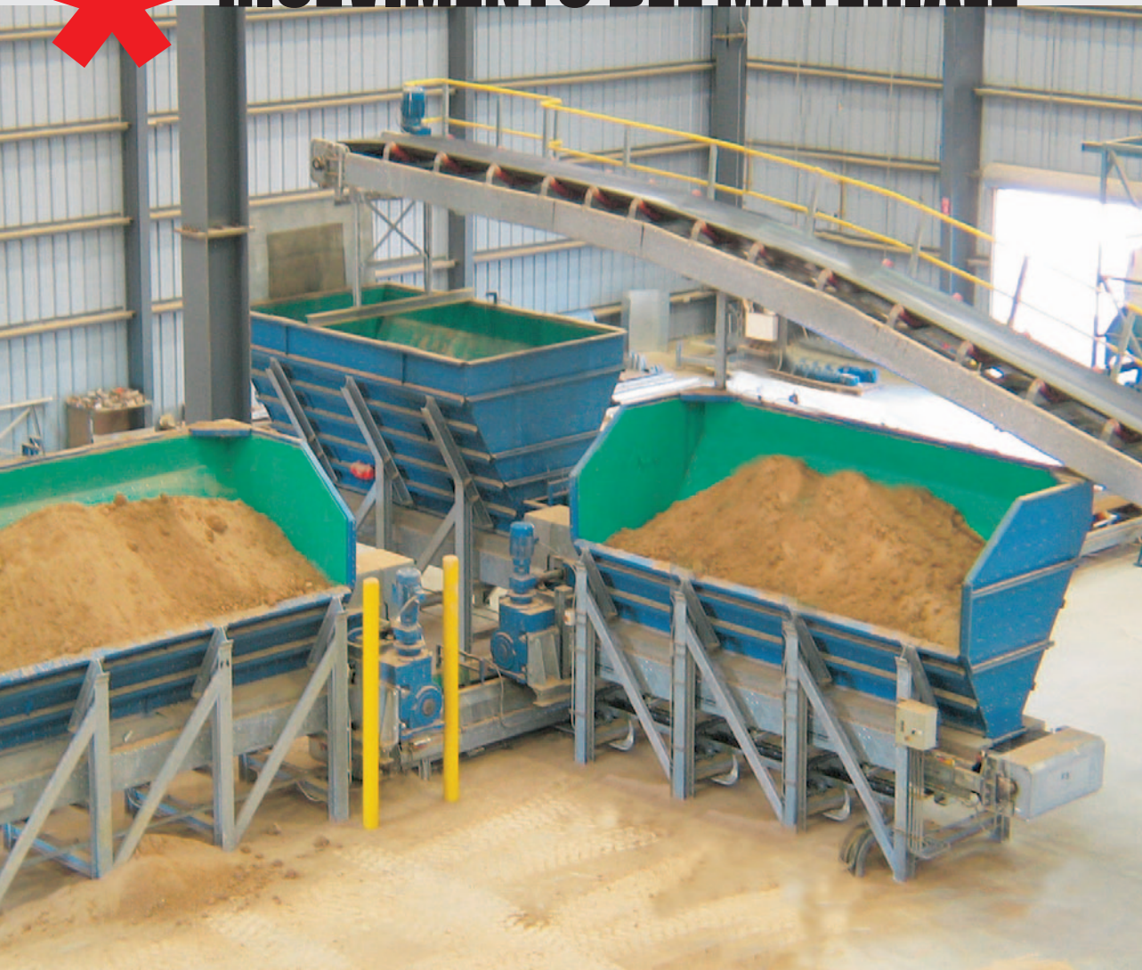
* Tramoggia di alimentazione
