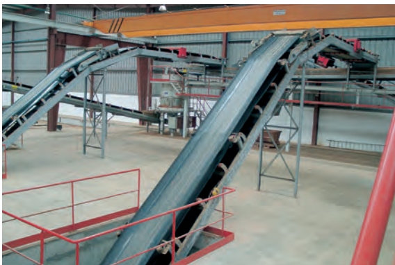
* Транспортировка отходов с помощью крытого ленточного транспортера
