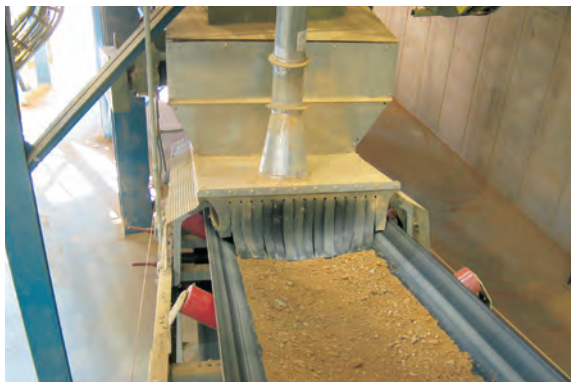
* Зона передачи с системой отсоса
