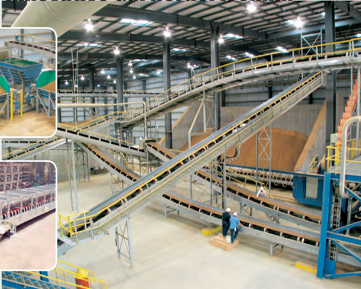
* fördern, lagern und verarbeiten von Rohstoffen
