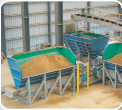
* Tramoggia di alimentazione
